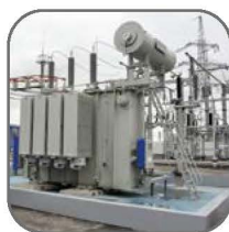
Объекты энергетической отрасли
